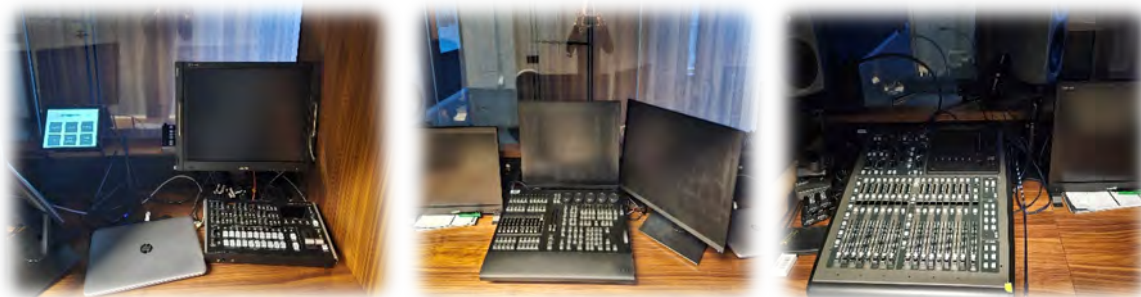
Opremljenost tehničnega prostora v Dvorani Alme Karlin
